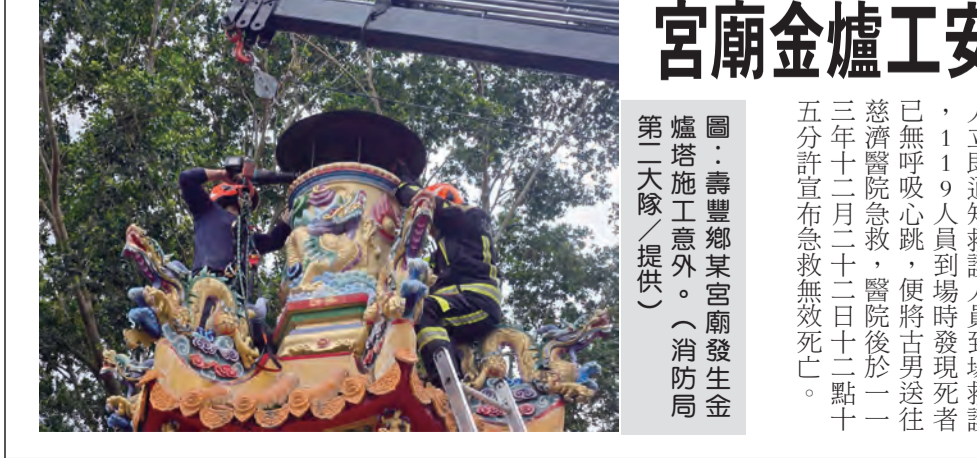
圖：壽豐鄉某宮廟發生金爐施工意外。(消防局第二大隊/提供)
